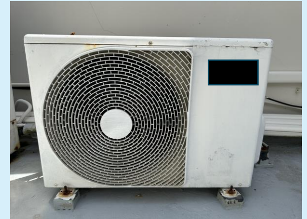
คอยล์ร้อนต่างแบรนด์ ติดตั้งปี 2018
